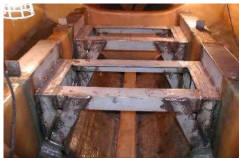
FRP 船に対し、鉄架台を設置した例
